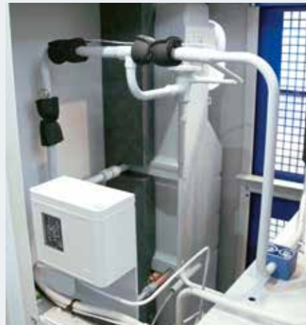
Vistas interiores del secador frigorífico con recubrimiento
